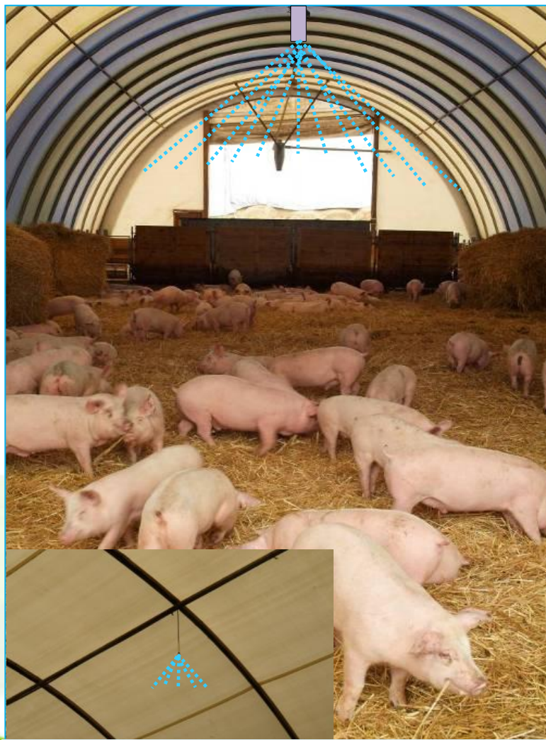
Sistema de pulverização nos hangares
